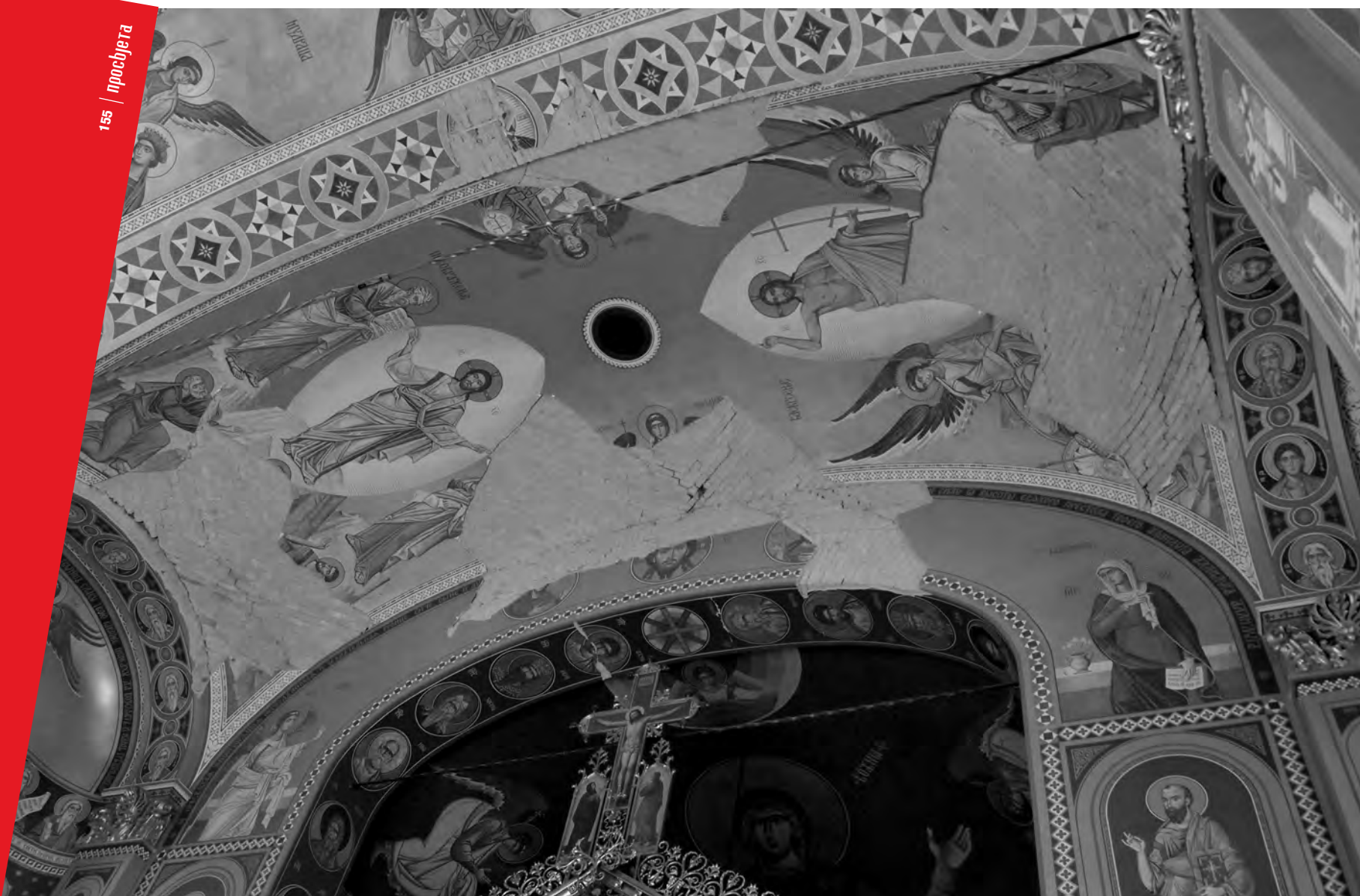
Oštećenja na svodovima u istočnom dijelu broda Preobraženjskog hrama, foto: Dragan Damjanović, 28. 3. 2020.
